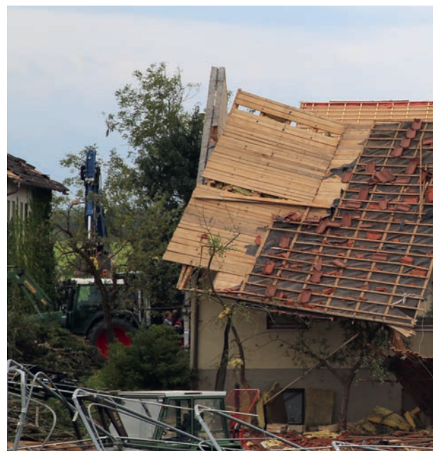
▼ Schäden durch einen Tornado in Affing (Bayern) am 13.5.2015.
