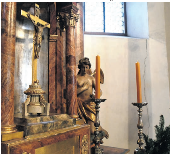
Auch in den Wänden der Kirche St. Michael sind Risse unübersehbar - hier neben dem Hauptaltar. Sie stellen aber kein unmittelbares Risiko dar.
