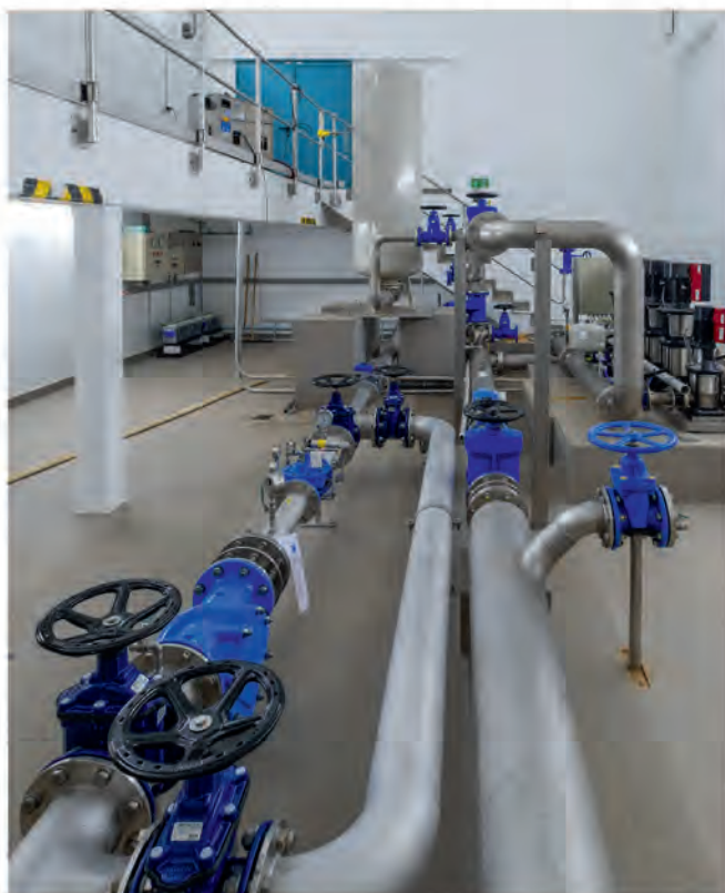
Ansicht der gesamten Druckanlagenerhöhung in Zeppelinheim.
