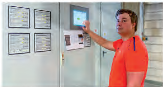
Routiniert steuert Lennart die Bädertechnik.
