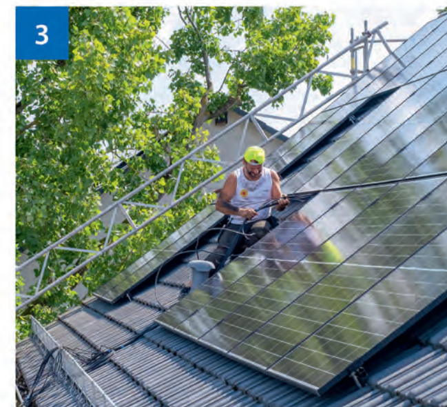
Die Module werden miteinander verschaltet.
