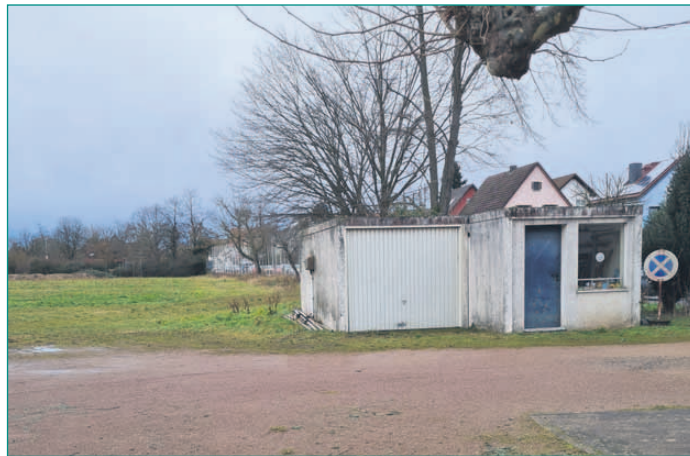
„Schandfleck Jahnsporplatz“ und daneben die seit vielen Jahren „reparaturbedürftige TGS Halle“.
