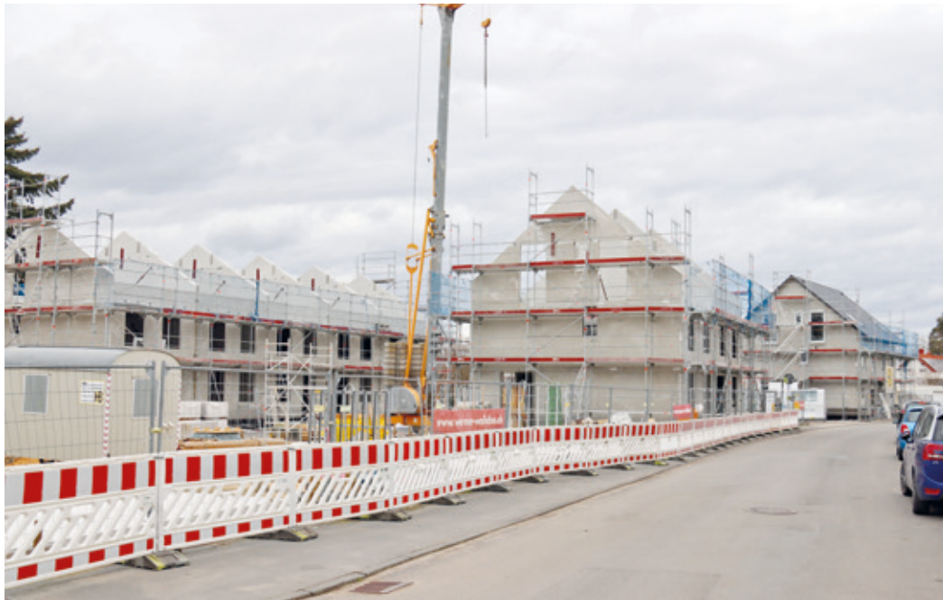
Die Baustelle Erzhäuser Straße in Wixhausen. Bis 1983 starteten hier LKWs. Jetzt sind 23 Wohneinheiten in 7 Häusern im Bau.
