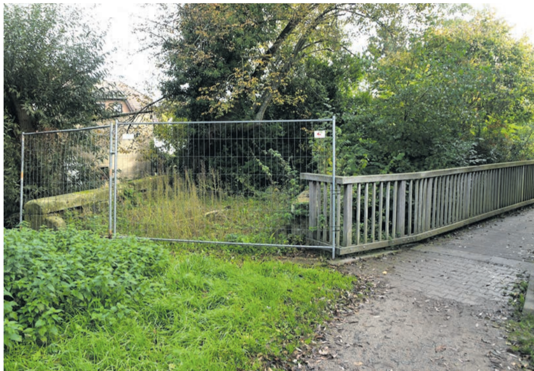
Die Brücke über die Semme bei Altheim (links im Bild der beschädigte historische Teil, rechts die neue Holzbrücke) säumt seit rund einem Jahr ein Bauzaun. Aus dem denkmalgeschützten Teil waren Steine rausgerissen worden. Sie sollen bald wieder eingesetzt und mit Epoxidharz besser befestigt werden. (Foto: jedö)
