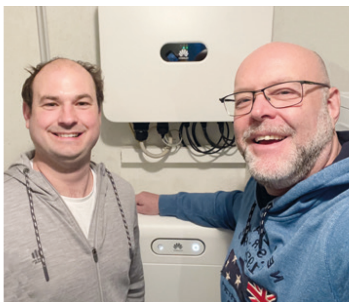
Unser Bild zeigt Daniel Moik (links) als projektbegleitenden Elektromeister der Firma ReviEnergie, sowie den Bauherren Martin Steinfels (rechts) vor der frisch in Betrieb genommenen Anlage.
