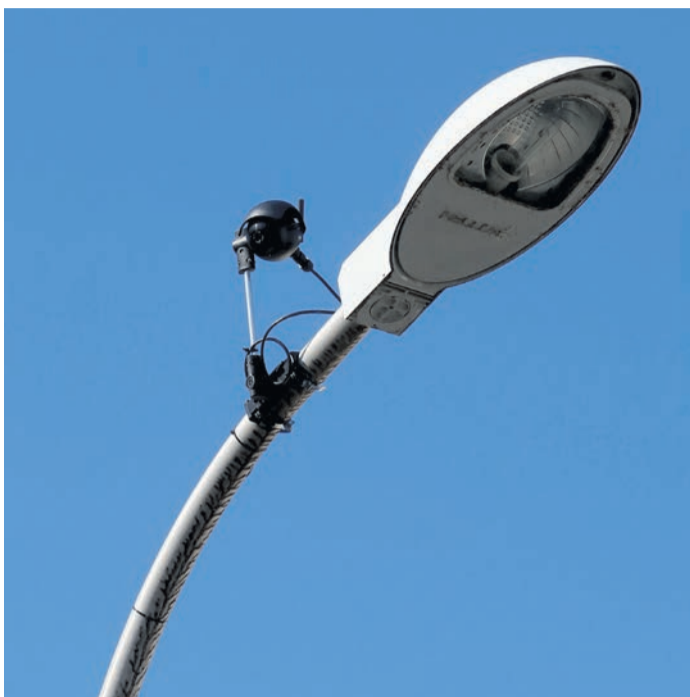
Smarte Straßenbeleuchtung in Rodgau.
