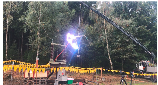
110 kV Erdschlussstrom-Messung – Freileitung (Foto: Privat)
