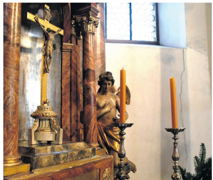
Auch in den Wänden der Münsterer Kirche St. Michael sind Risse unübersehbar - hier neben dem Hauptaltar. Sie stellen aber kein unmittelbares Risiko dar. Die nächsten Investitionen sollen in den Eingang und das Dachgebälk fließen.
