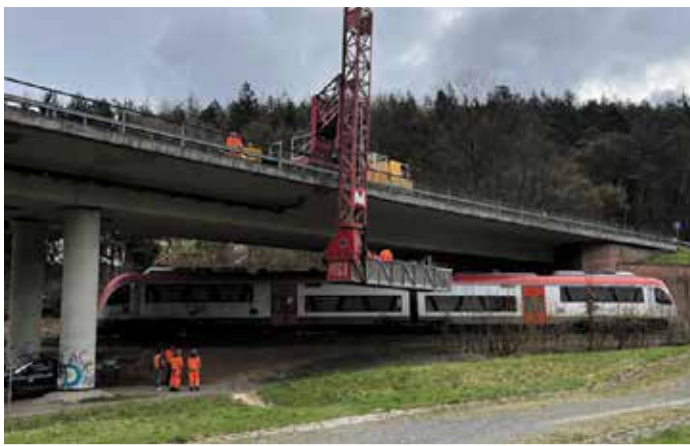
Bei einer Sonderprüfung wurden Risse im Beton entdeckt: Die Brücke bei Bad König-Zell ist gesperrt. Foto: Hessen Mobil
