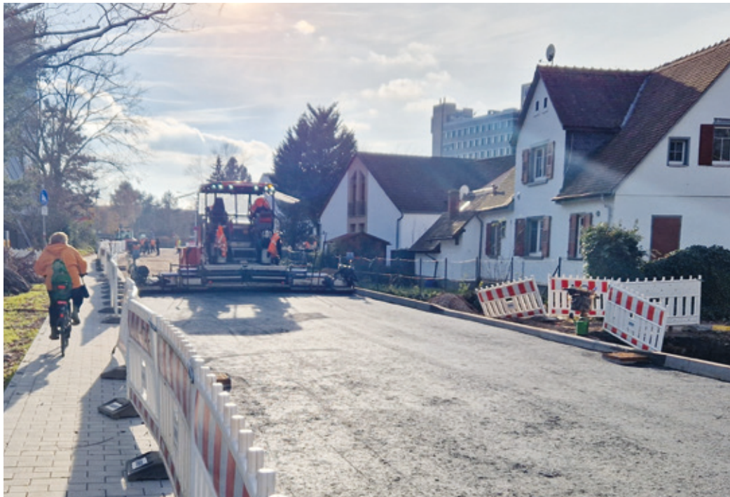
Derzeit wird die erste Teerschicht auf der Jägertorstraße zwischen Waltherstraße und Gruberstraße aufgebracht, hier neben der Kleinen Kirche am See (links) mit Blick zur Kreuzung Gruberstraße. Freudig begrüßt wurde von Teilnehmern der Stadtteilrunde, dass der nun ausgebaute Fußweg entlang dem Brentanensee bereits freigegeben ist. (Foto: dv)
