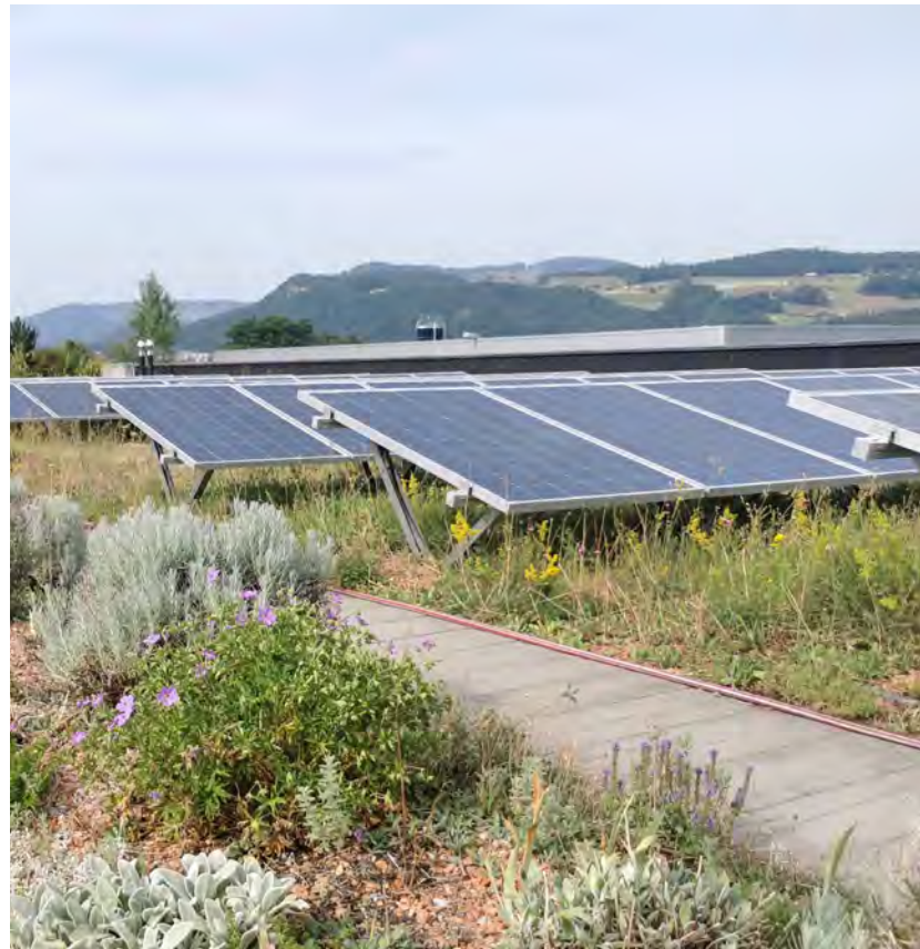
Abbildung 97: Begehbare Solargründach – zentrale Maßnahme des Klimavorbehalts zur Verbesserung der Klimaresilienz. Quelle: GRUEN-STATTGRAU
