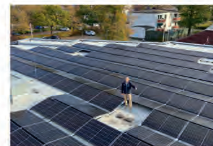
Mit Sonnenkraft in die Zukunft: Stadtwerke-Chef Kirk Reineke inmitten der neuen Solaranlage auf dem Dach des WaldSchwimmbads Neu-Isenburg
