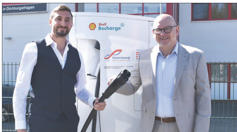
Hand in Hand für die Transformation von fossilem hin zu E-Antrieb und Klimaschutz im Odenwaldkreis: Landrat Frank Matiaske (r.) und Alexander Wissmüller eröffnen den neuen Ladepark auf dem Omnibusbetriebshof der Firma Wissmüller in Michelstadt. Foto: Konstantina Koch, Kreisverwaltung
