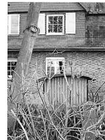
Abb.2 Materialfremde Fenster und Klappläden, verunstaltende Gartenhütte im Vorgarten
