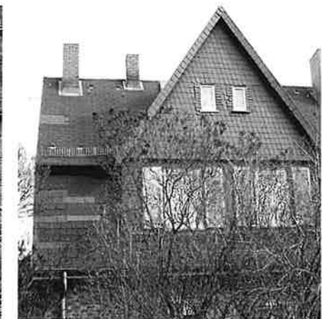
Abb.3 Verwendung von unhistorischem Baumaterial für die Dacheindeckung
